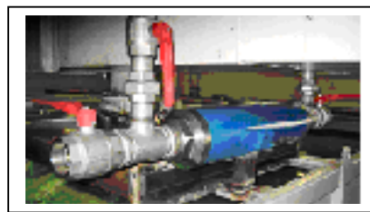
FM-Polariseur sur une installation centrale
